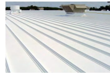
REJEIÇÃO DE CALOR
